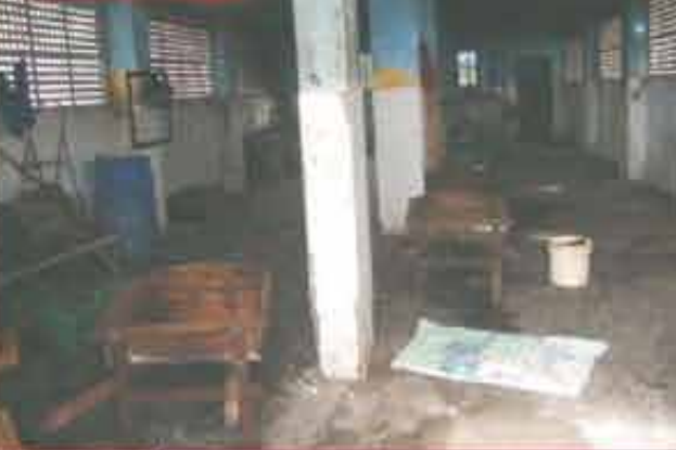
Detalhe de escoamento do efluente do anexo do matadouro público da cidade de Pacajus
