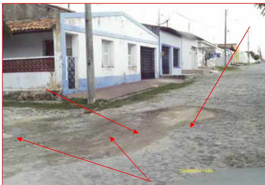
FIGURA 23 – Extravasamento do poço de visita do sistema de coleta de esgoto da cidade de Chorozinho.
